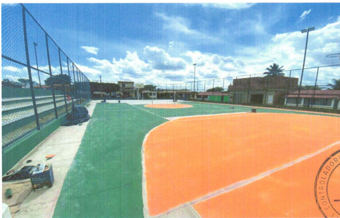
FOTO 08 - PINTURA DE ACABAMENTO COM APLICAÇÃO DE 02 DEMÃOS DE TINTA PVA LÁTEX PARA INTERIORES/EXTERIORES - CORES ESPECIAIS MISTURADAS EM MÁQUINA, TONS CLAROS (MARFIM,PÉROLA,ETC) - REV 01 - (COR VERDE)
